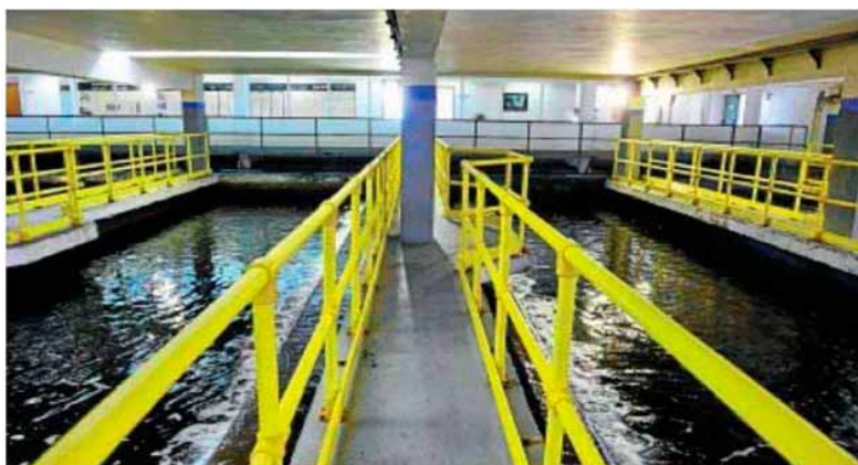
Interior de las instalaciones de desalación de Piedra Santa. JUAN CARLOS ALONSO
